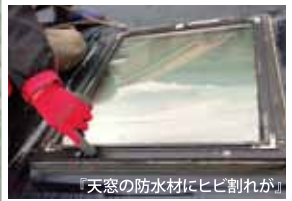
「天窓の防水材にヒビ割れが」
